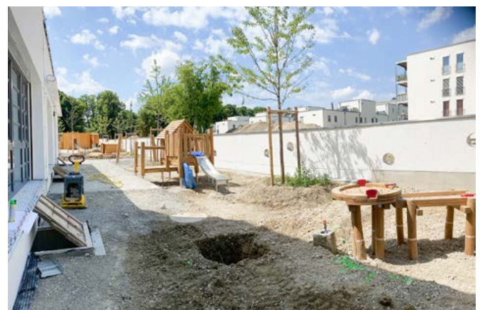
→ Die Baustelle im Prinz-Eugen-Park lässt erahnen, dass hier bald Kinder lachen und spielen werden.
